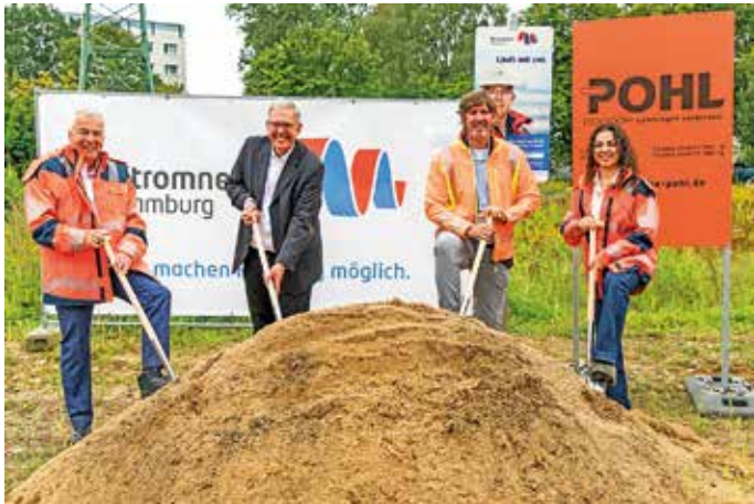
Symbolischer erster Spatenstich in Tonndorf, v. l.: Dr. Andreas Cerbe vom Stromnetz Hamburg, Baudezernent Arne Klein, Generalunternehmer Hannes Pohl und Projektleiterin Reem Faris Khazaal. Foto: Dirk Uhlenbrock
