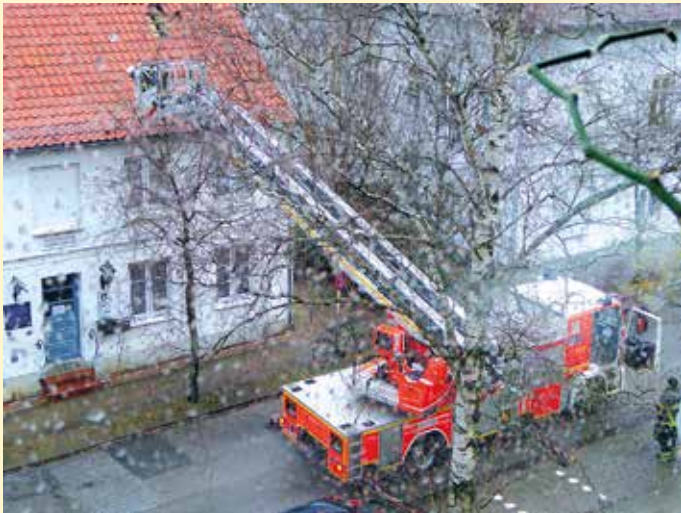
Feuerwehreinsatz auf dem Dach des Heimatmuseums während eines Sturms im März 2015. Foto: Dagmar Homburg
