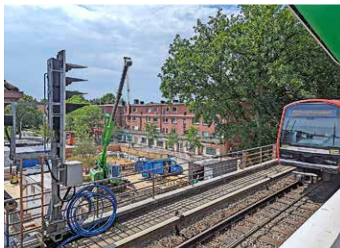
Tödlicher Unfall auf der Großbaustelle an der U-Bahn-Station Wandsbek Gartenstadt. Foto: Winfried Mangelsdorff
